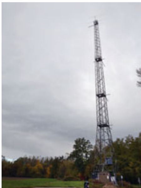
Antenne der Station OE3XAS mit Shack darunter
