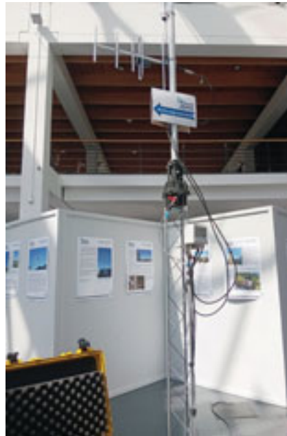
Abb. 4: Antennenmast mit UKW-Antenne (Foto: OE9LTX)
