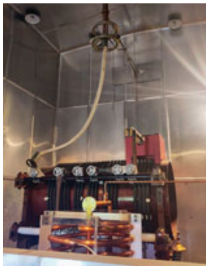
Anspeisung der LW-Antenne des WWVB-Senders
