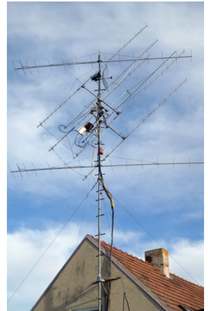
Antennen der OE3JPC-Station
